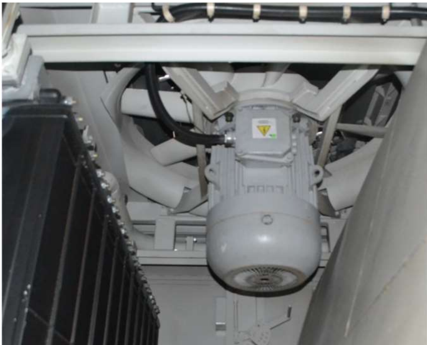
Рис.3.20 Вентилятор холодильной камеры МВ-14В2
