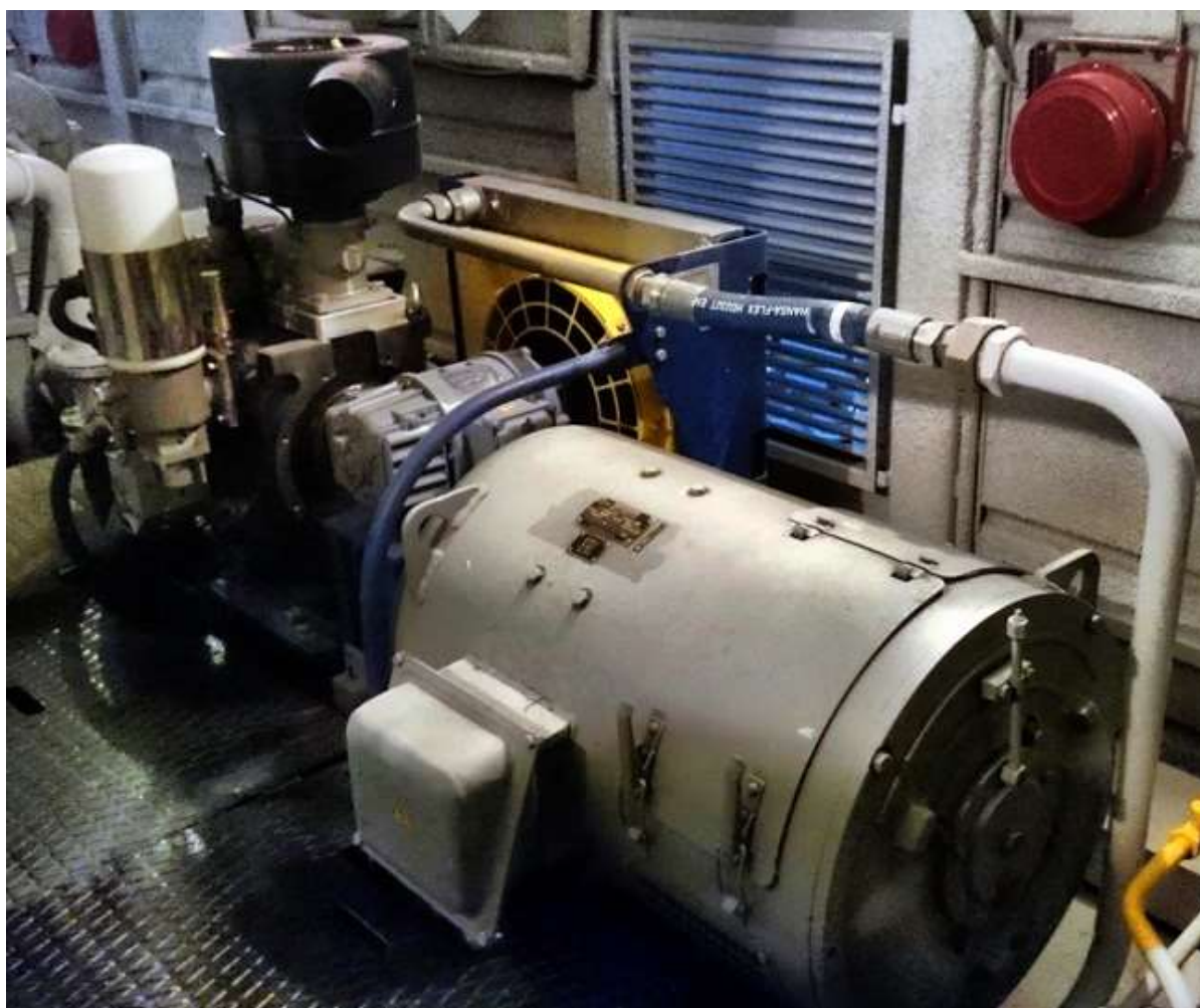
Рис.3.24. Электродвигатель компрессорного агрегата
